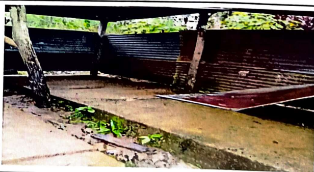
Foto 6: pila de captación de agua no iniciada
